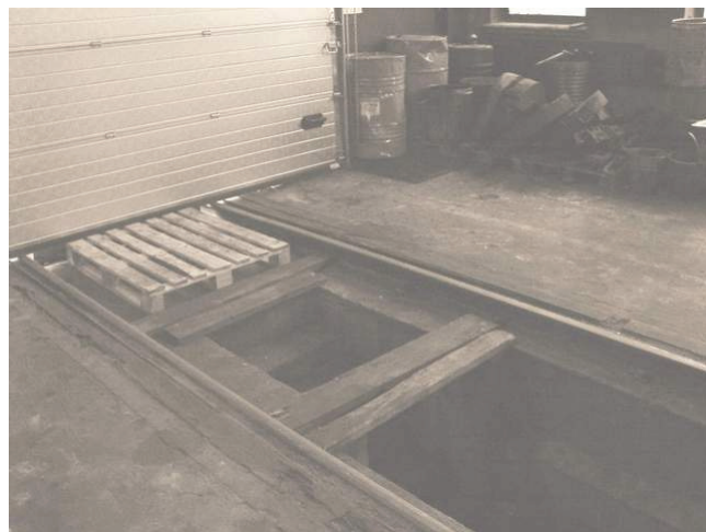
Kanał naprawczy niezabezpieczony przed możliwością wpadnięcia
